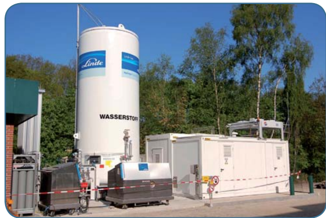
Die Betankungsanlage auf dem U-Bahn-Betriebsgelände der HOCHBAHN in der Hellbrookstraße.
